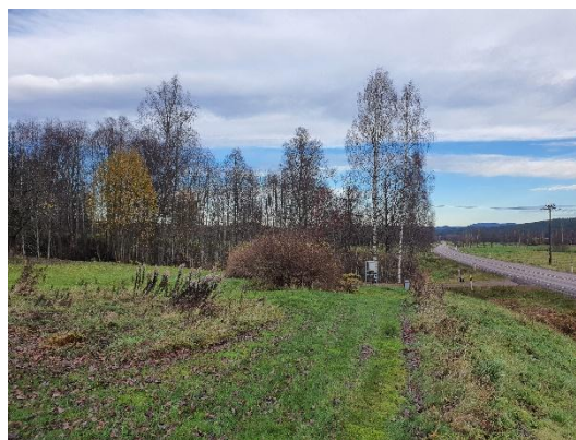
Strax söder om avtagsvägen till Ulvsby 1:66 har marken schaktats ur. Pumpstationens elskåp syns till höger om den större busken mitt i bilden.
