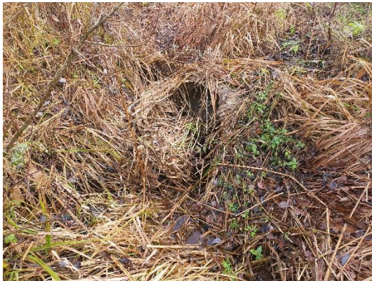
Inloppet till trumman under E45 vid det sänka partiet.
